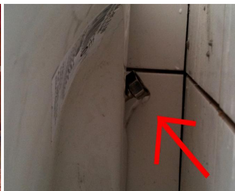
Figura 02: Vazamento nas tubulações sanitárias.
